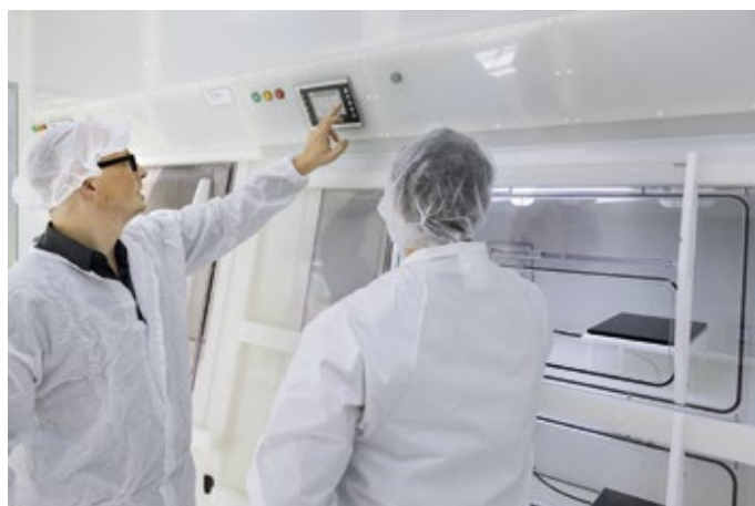
Abb. 3: Über integrierte Touchdisplays wird die Lüftungs- und Versorgungstechnik an den Arbeitsplätzen individuell gesteuert.
