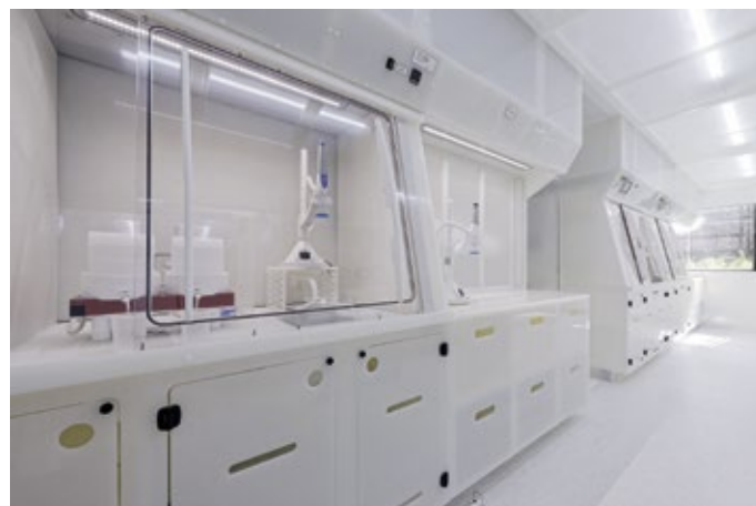
Abb. 2: Die fünf Arbeitsplätze sind absolut metallfrei und bieten Partikelfreiheit auf dem Niveau der Klassen 4 und 5 gemäß DIN EN ISO 14644.
